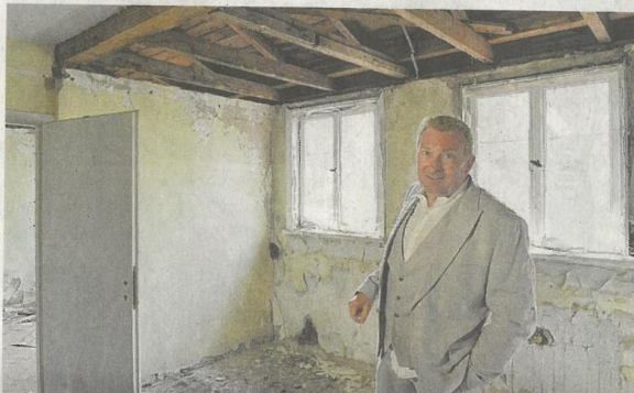
Arne Gorzolla vom BBF Baubüro Freiberg sagt, er sei seit viereinhalb Jahren in die Planungen für das Gebäude eingebunden: „Wir wollten die Decke im Dachgeschoss anheben, aber das hat der Denkmalschutz nicht zugelassen.“
