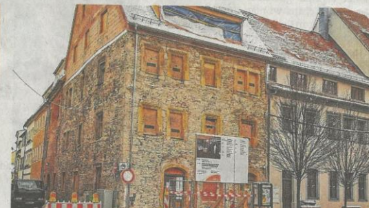
An der Burgstraße 38 ist das Gerüst gefallen. Das Gebäude soll, nachdem es wieder ein Dach hat, zunächst weiter trocken und dann gemeinsam mit dem Nachbarhaus Nummer 36 (rechts) weiter hergerichtet werden.
