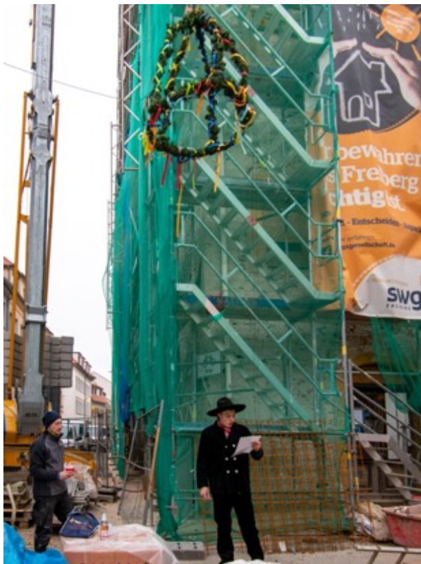
Zimmermann Carsten Seipelt von der Zimmerei Wolf verliest den Richtspruch, während die Richtkrone von einem Kran auf das neu erstellte Dach der Burgstraße 38 gehoben wird. © SWG Freiberg
