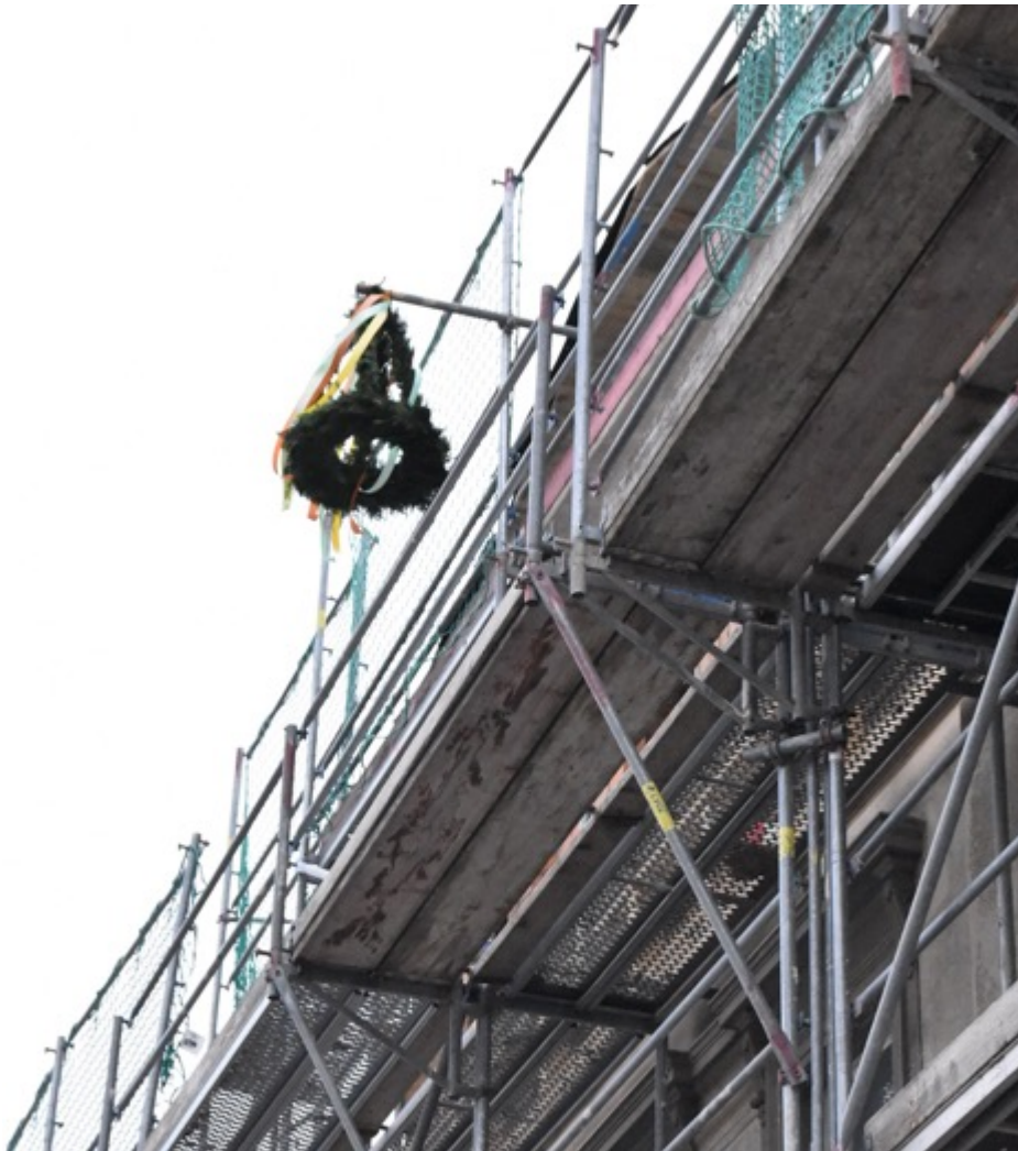
Zum Richtfest mit Handwerkerfest am 6. Februar 2020 wurde die Richtkrone am Haus Nr. 20 befestigt. © SWG Freiberg
