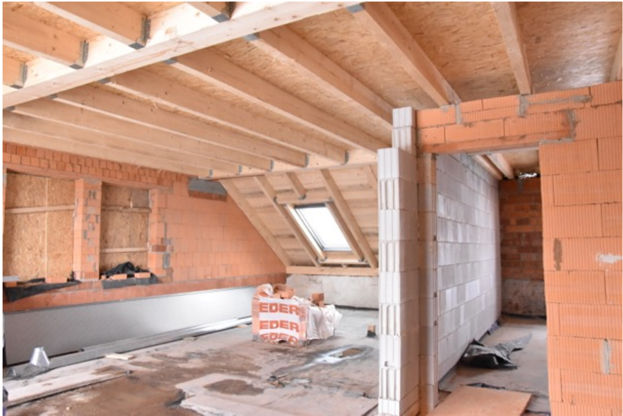
Der Dachstuhl ist fertig, am 6. Februar 2020 wurde das Richtfest mit einem Handwerkerfrühstück gefeiert. © SWG Freiberg
