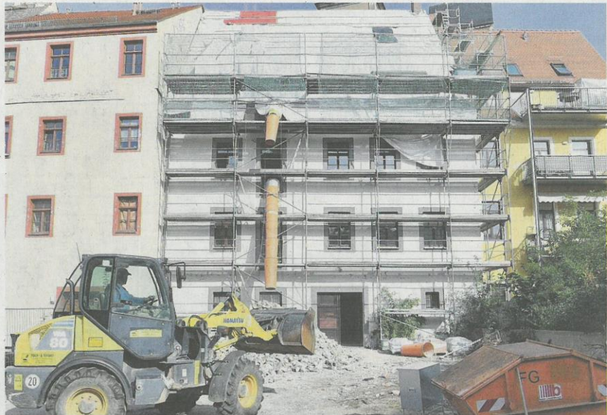
Mitarbeiter der Firma ABT Großhartmannsdorf sind derzeit mit Entkernungsarbeiten im Gebäude am Petriplatz 3 in Freiberg befasst. Die Städtische Wohnungsgesellschaft lässt das Haus aktuell sanieren. Unter anderem soll die Volkshochschule darin Platz finden.
