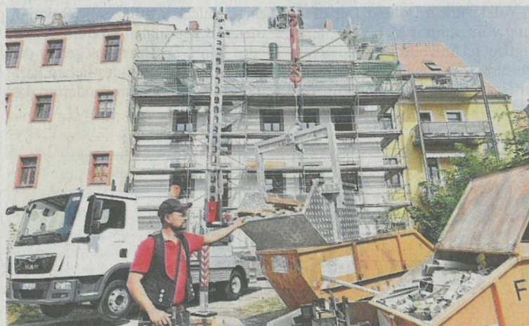
Dachdeckermeister Thomas Haustein aus Nossen transportierte gestern alte Dachlatten von der Baustelle am Petriplatz ab.
